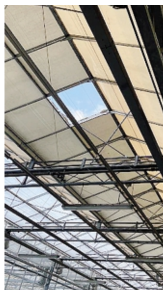
Una serra danneggiata
